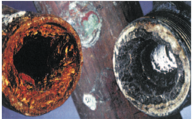
Rys. 21. Skorodowane rury ołowiane.
